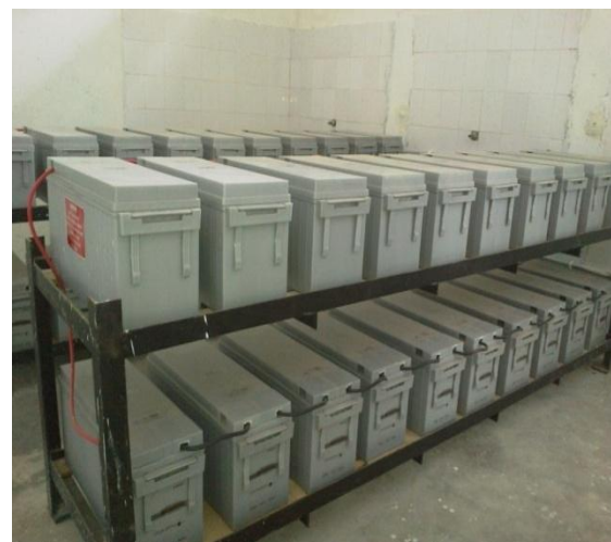
Fig: 5.a: Solar Batteries
